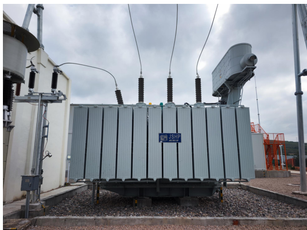
图片 9 现有工程主变及事故油坑
