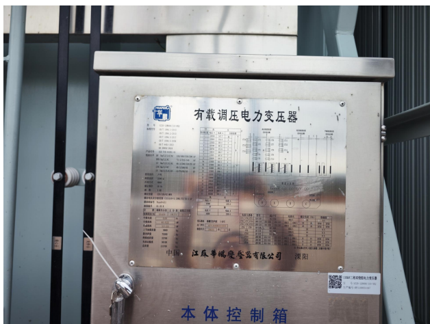
图片 10 现有工程主变铭牌
